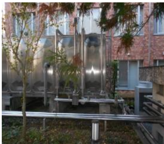
1号館市水送水関係バルブ
