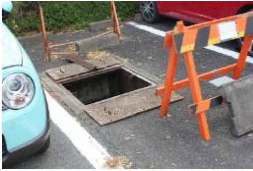
地下原水ポンプ(1層目)
