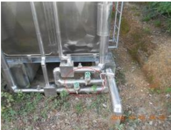
井水(原水)受水槽関係バルブ
