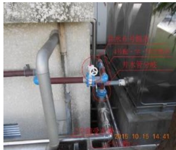
原水槽送水関係分岐バルブ
