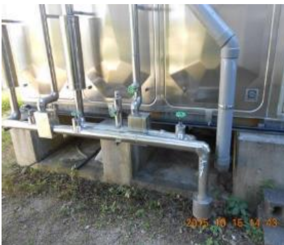
3号館市水受水槽関係バルブ
