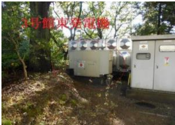
3号館発電機(3号館東側)
