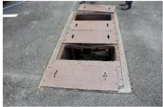
地下定量ポンプ(2層目)
